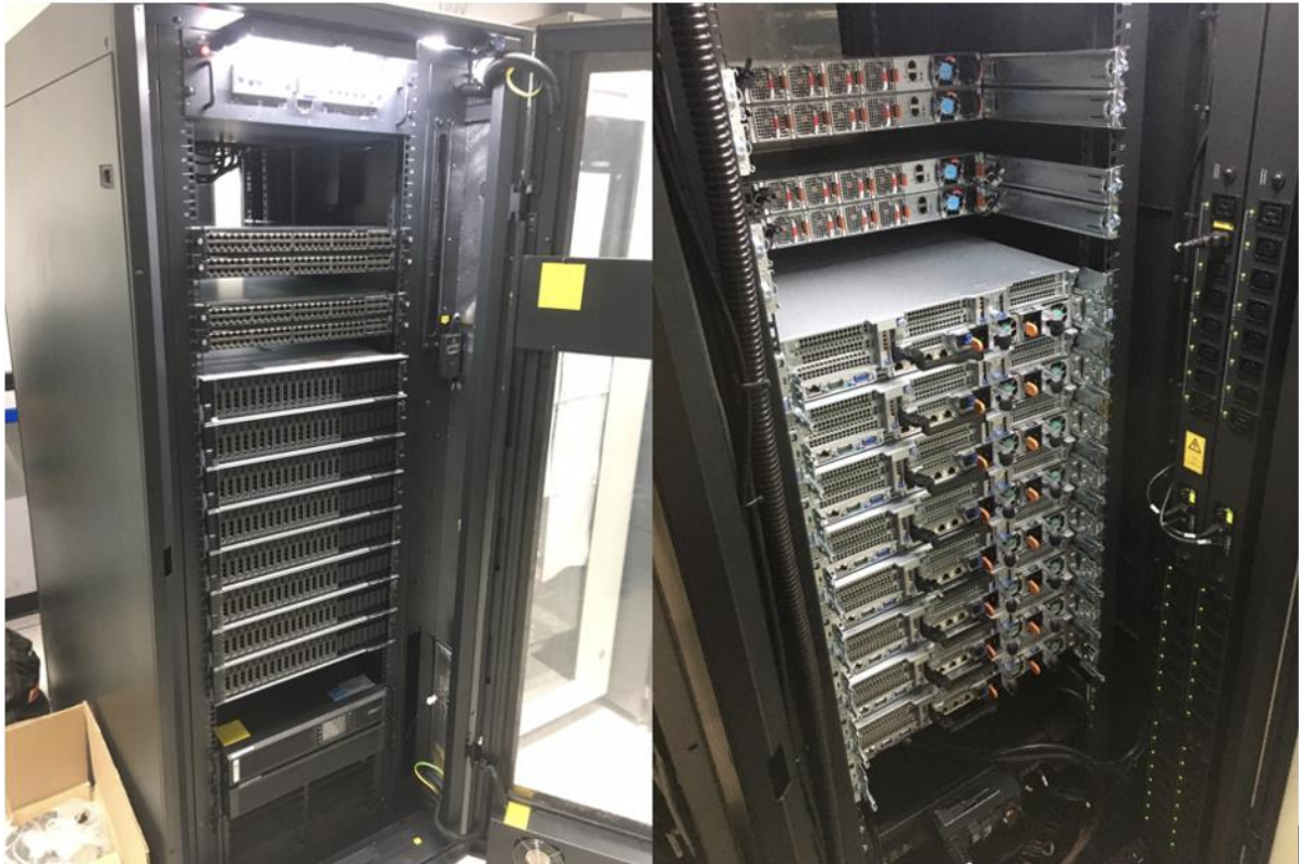
รูปภาพที่ 103 เครื่องคอมพิวเตอร์แม่ข่าย และอุปกรณ์เครือข่ายเพื่อเชื่อมโยงเซิร์ฟเวอร์ (Networking Switch) ที่ติดตั้งพร้อมใช้งาน ณ ห้อง Data Center ศูนย์เทคโนโลยีสารสนเทศและการสื่อสาร สำนักงานสภาพัฒนาการเศรษฐกิจและสังคมแห่งชาติ
